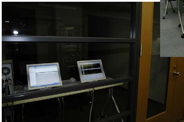
サーバールーム
